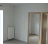
Διαμόρφωση 6 διαμερισμάτων σε υφιστάμενο κτήριο στο Στρδο «ΠΑΠΑΝΑΣΤΑΣΙΟΥ» (Πρώην κτήριο ΙΛΗΣ) στην Ορεστιάδα
